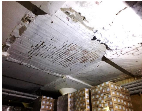
Рис. 4. Дефекти руйнування захисного шару арматури плит у камерах 5 поверху
