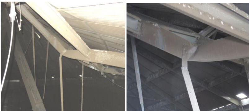
Рис. 2.8. Руйнація вузлових з'єднань коробів до балок покриття силосу
