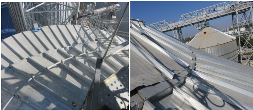
Рис. 2.5. Нещільність лицювання покриття башт силосу
