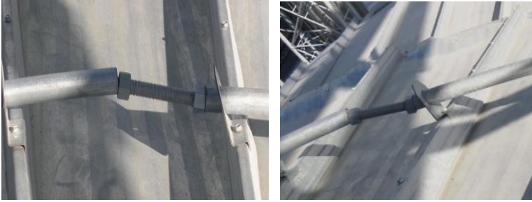
Рис. 2.10. Значні деформації болтових з'єднань конструктивних елементів споруди башти силосу
