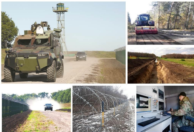
Рис. 2. Приклади інженерно-технічного облаштування державного кордону. Фото прес-служби ДПСУ: С. Гудака, В. Олійника, Д. Сливного
