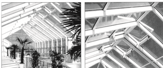
Вентиляційні вікна вздовж коника даху в робочому стані
